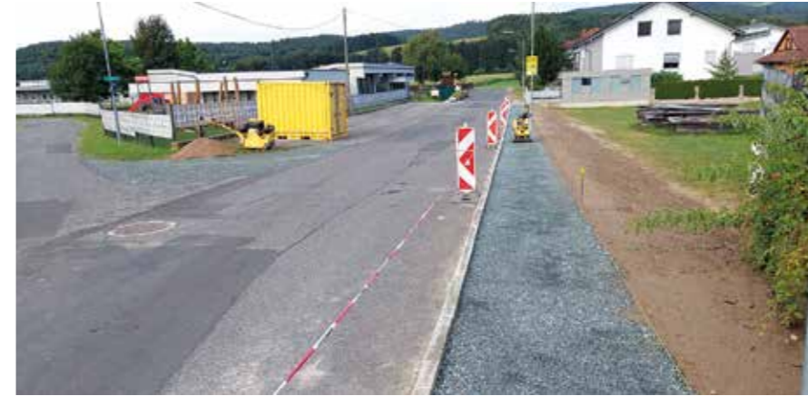
Bis zum Schulanfang wird auch der Gehsteig rund um die Schule fertig sein.
